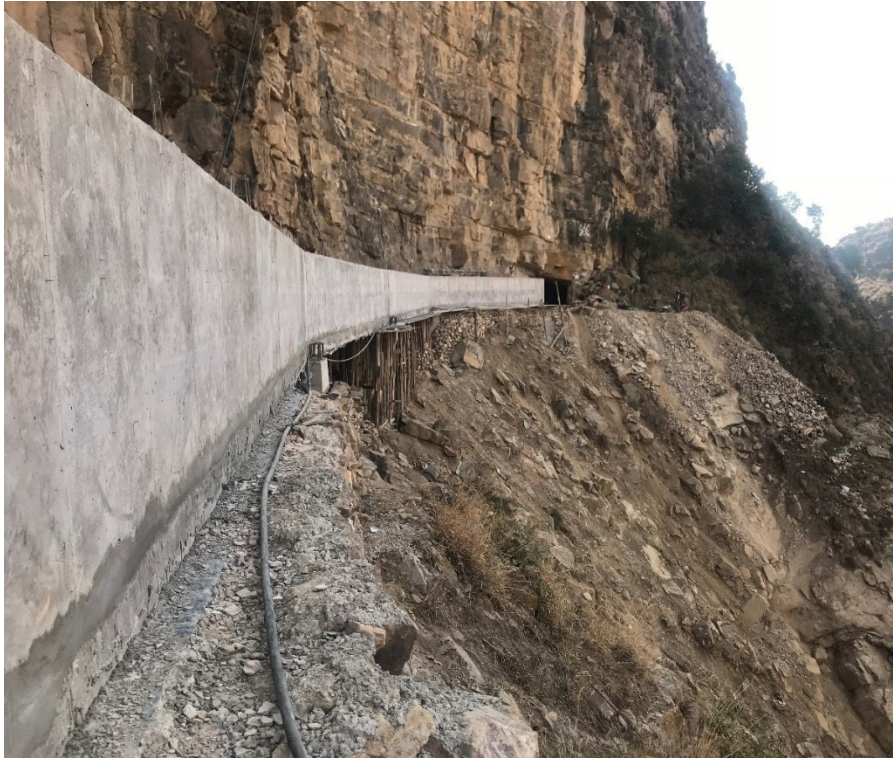
Fotografía: Inspección a Puente Canal en la Salida del Túnel en fecha 06/07/2018
