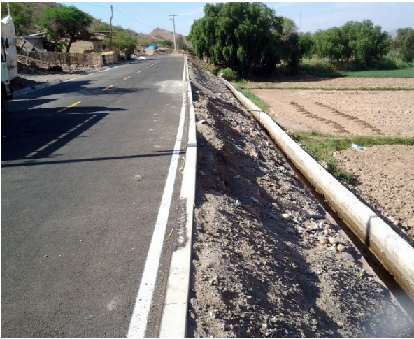
Fotografía: Taludes Inestables
